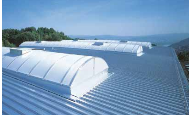
Gesamtschule Vallendar (D) vor und nach der Sanierung; Profiltyp: 50/429, stucco-dessiniert Architekt: Guido Fries Architekten, Vallendar
